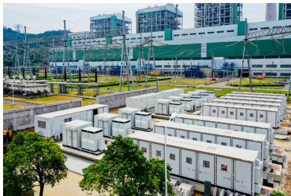
图释 01 – 储能电站
